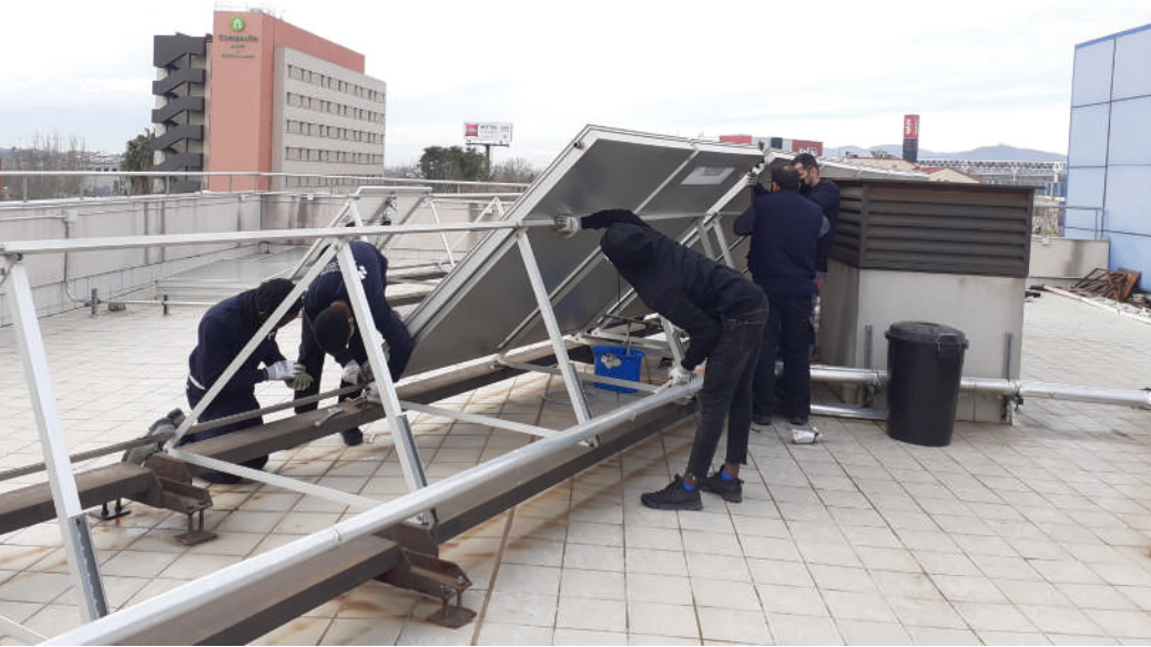
Sustitución de una parte de las placas térmicas para poner las placas fotovoltaicas que nos ha cedido CHINT.
